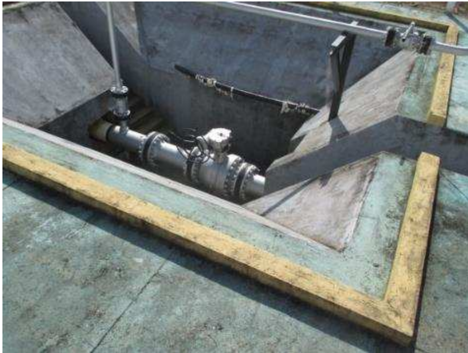
Figura 2. Válvula no Entroncamento Pilar-Furado/Anambé. Fonte: Petrobras.
