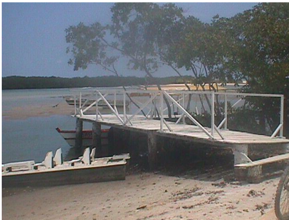
Atracadouro ilegal no canal de Fora – Barra Nova – Marechal Deodoro, Alagoas (Brasil)
